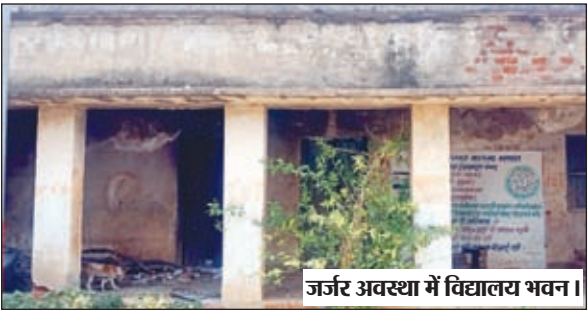
जर्जर अवस्था में विद्यालय भवन ।
