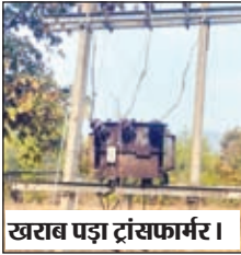
खराब पड़ा ट्रांसफार्मर।
