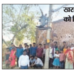
खराब ट्रांसफार्मर को दिखाते ग्रामीण।
